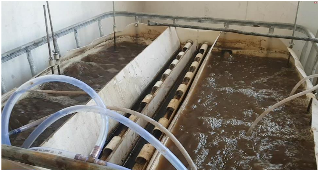
Рисунок 4.21 - Общий вид аэротенка-осветлителя с затопленной эрлифтной системой аэрации
