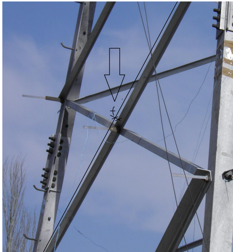
Рисунок 3.2 - Фиксирование выгиба решетки нижней части опоры
