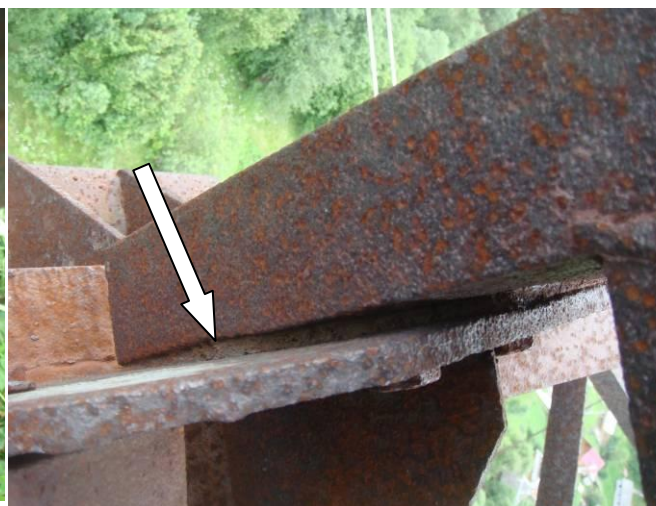
Рисунок Б.3.18 - Щелевая коррозия в стыках крепления поясов тросостоек к фасонкам траверс
