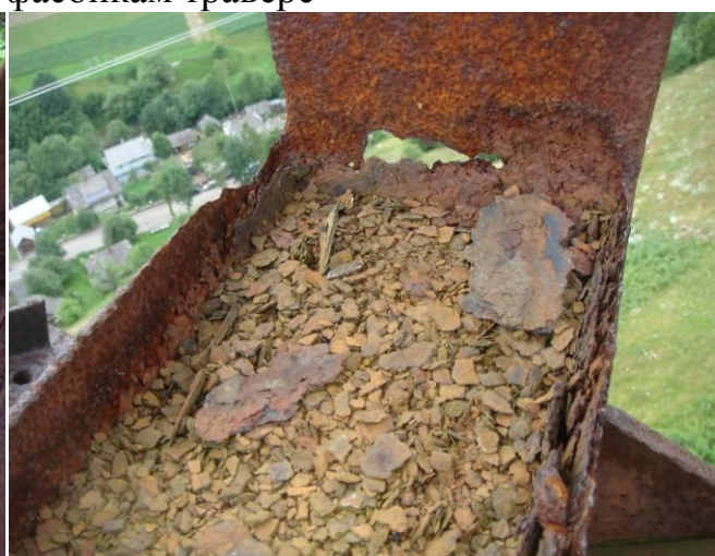
Рисунок Б.3.20 - Коррозия распорок и поясов тросостоек
