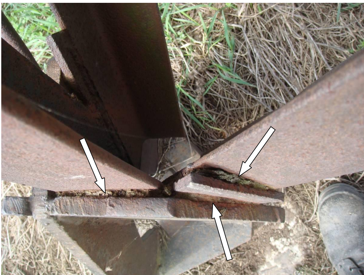
Рисунок Б.2.3 - Щелевая коррозия металла в соединениях в местах примыкания пояса и раскоса к башмаку
