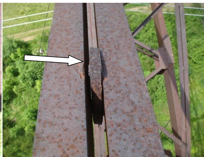
Рисунок Б.3.10 - Трещины в сварных швах крепления сухарей тяжелой траверс
