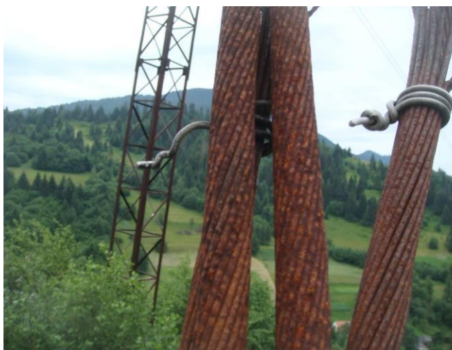
Рисунок Б.3.27 - Коррозия оттяжек
