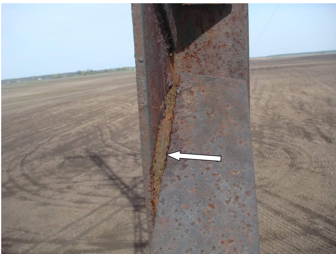
Рисунок Б.2.8 - Щелевая коррозия металла в узлах крепления раскосов к поясам
