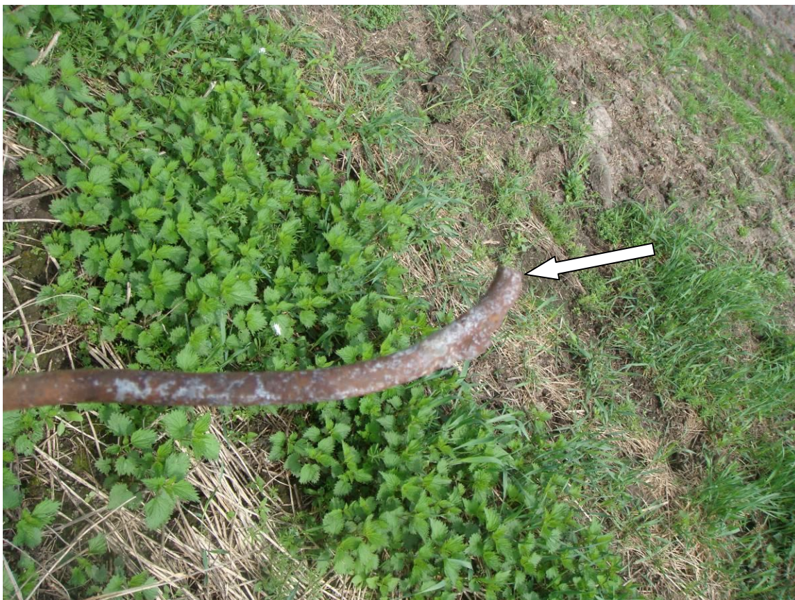
Рисунок Б.2.14 - Повреждение заземления
