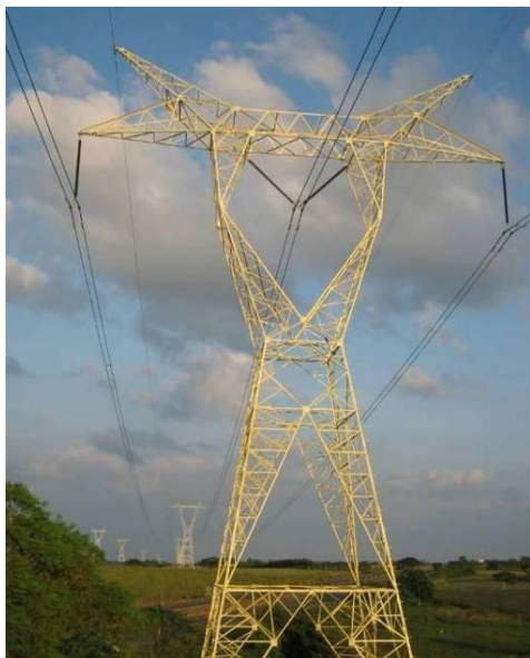
Рисунок 1.13 - Промежуточная опора ВЛ типа «кошачья голова» (Мексика).
