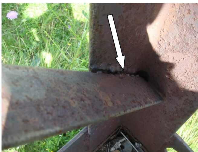
Рисунок Б.3.9 - Трещины в сварных швах в местах крепления раскосов
