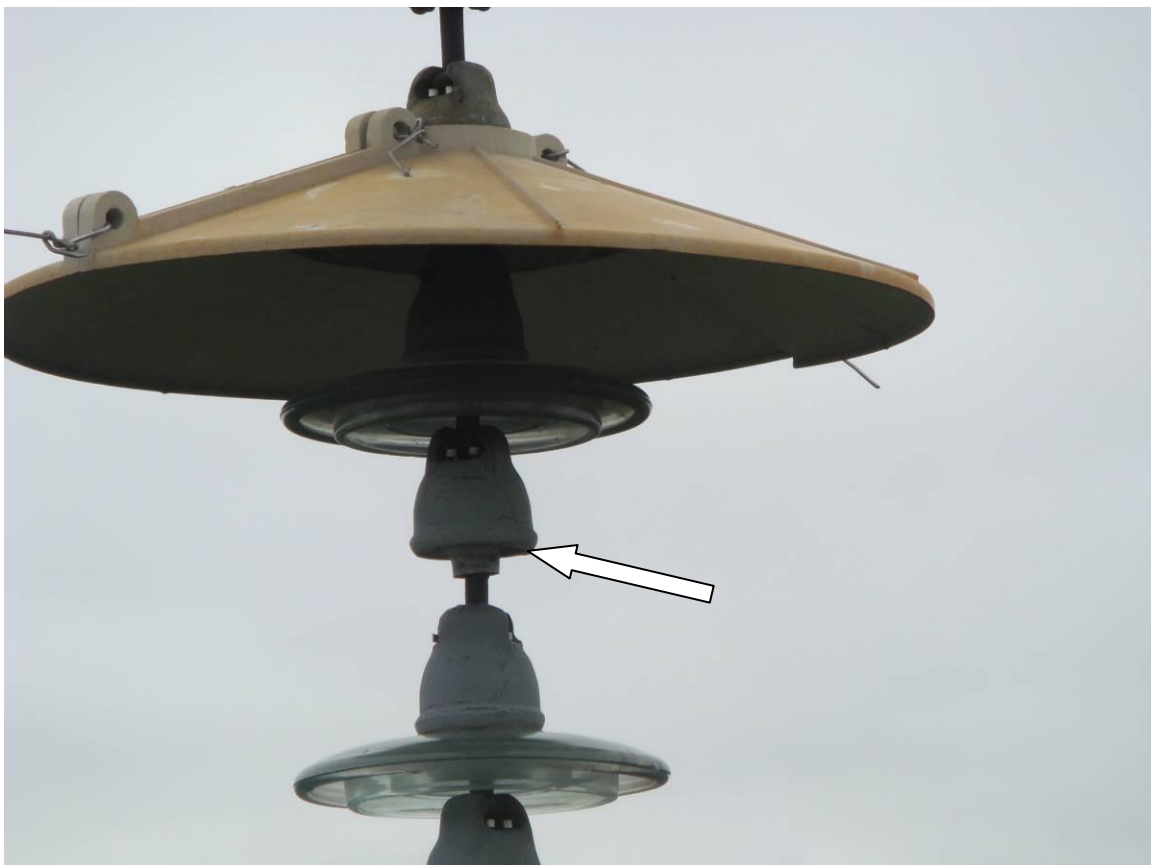
Рисунок Б.2.12 - Повреждение изоляторов
