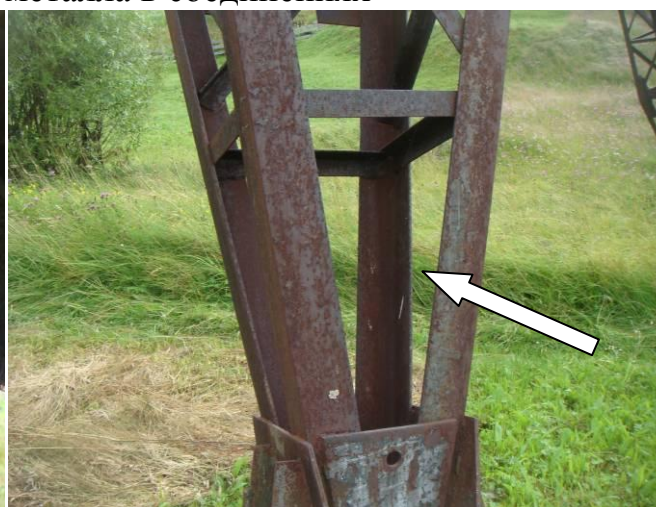
Рисунок Б.3.32 - Отсутствуют стержни опоры
