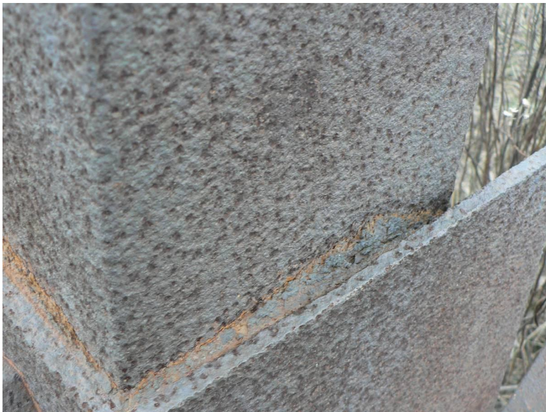
Рисунок Б.1.9 - Общая поверхностная коррозия и раковины на поверхности металла
