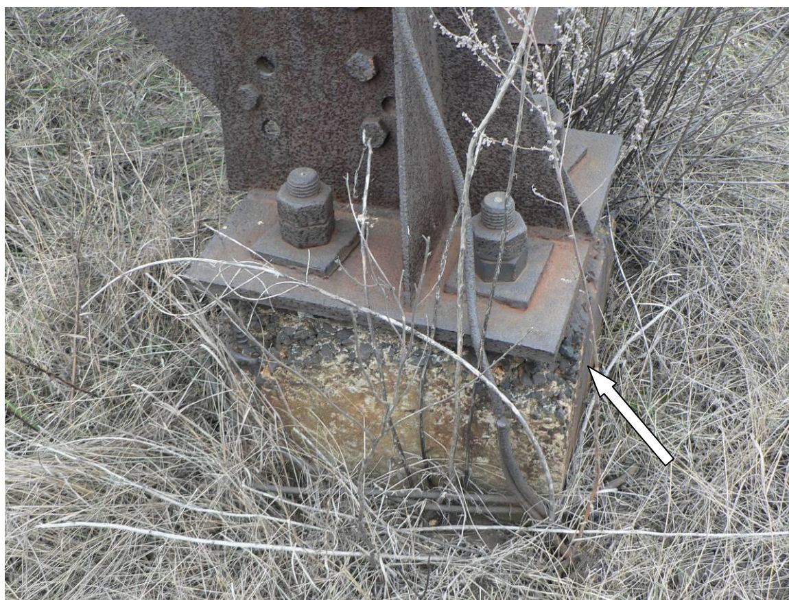
Рисунок Б.1.8 - Разрушение защитного слоя бетона фундаментов. Коррозия арматуры
