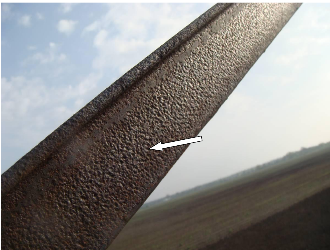
Рисунок Б.2.10 - Общая поверхностная коррозия и раковины на поверхности металла
