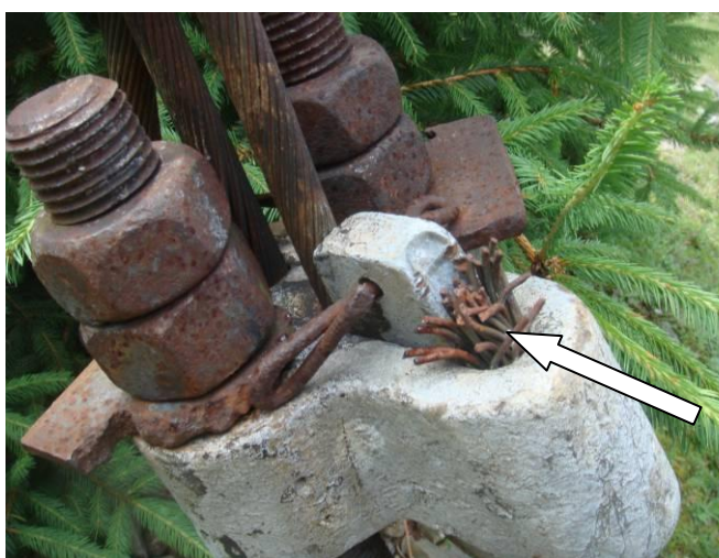
Рисунок Б.3.25 - Повреждения оттяжек. Канат обрезан после клинового зажима
