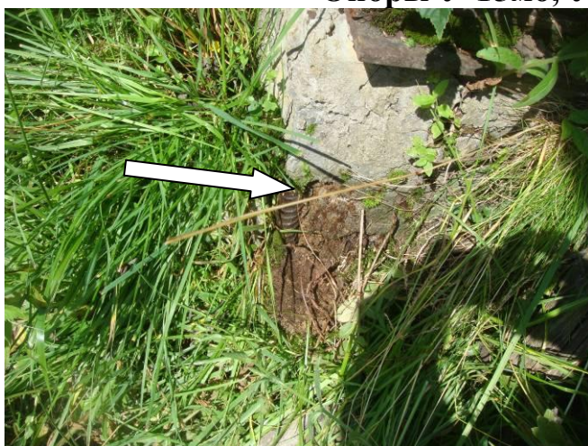
Рисунок Б.3.29 - Разрушение бетона фундаментов
