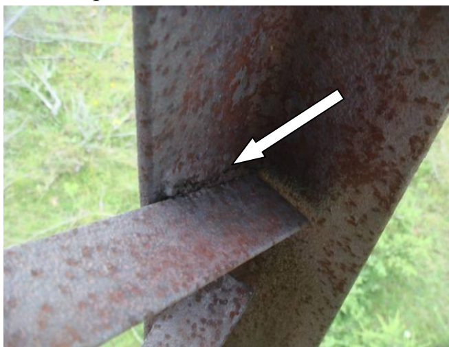
Рисунок Б.3.23 - Трещины в сварных швах
