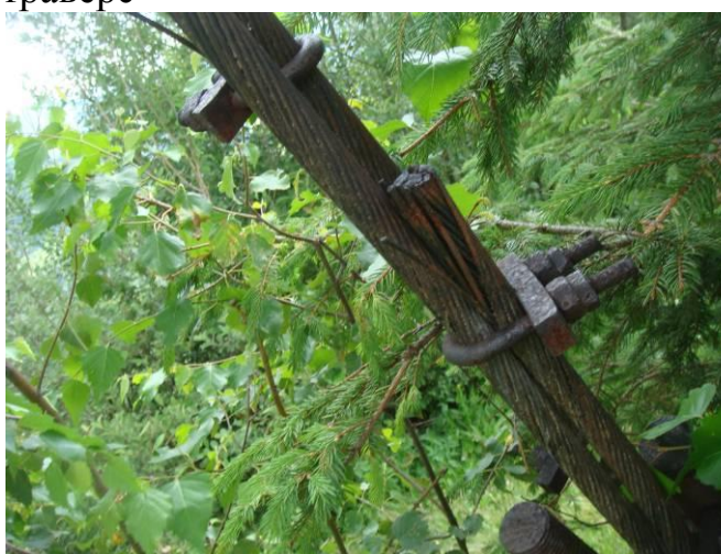
Рисунок Б.3.13 - Повреждения оттяжек. Отсутствуют 2-е сжимы
