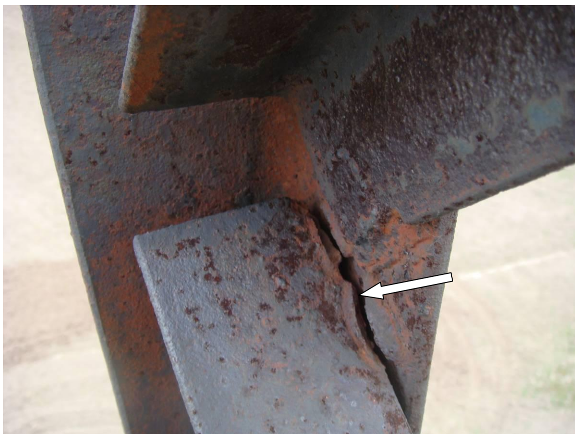
Рисунок Б.2.2 - Трещины в сварных швах и отрыв сварных швов
