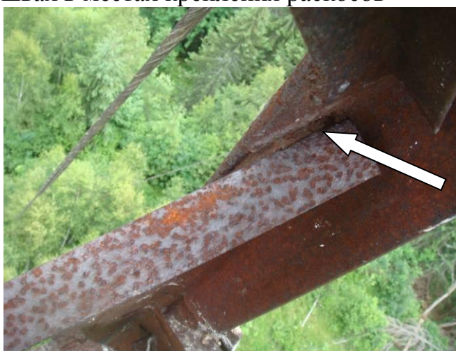
Рисунок Б.3.11 - Трещины в сварных швах в оп.322 по верхним поясам траверс
