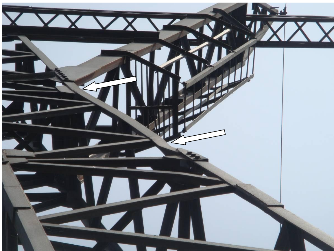
Рисунок Б.2.9 - Общая деформация ствола опоры
