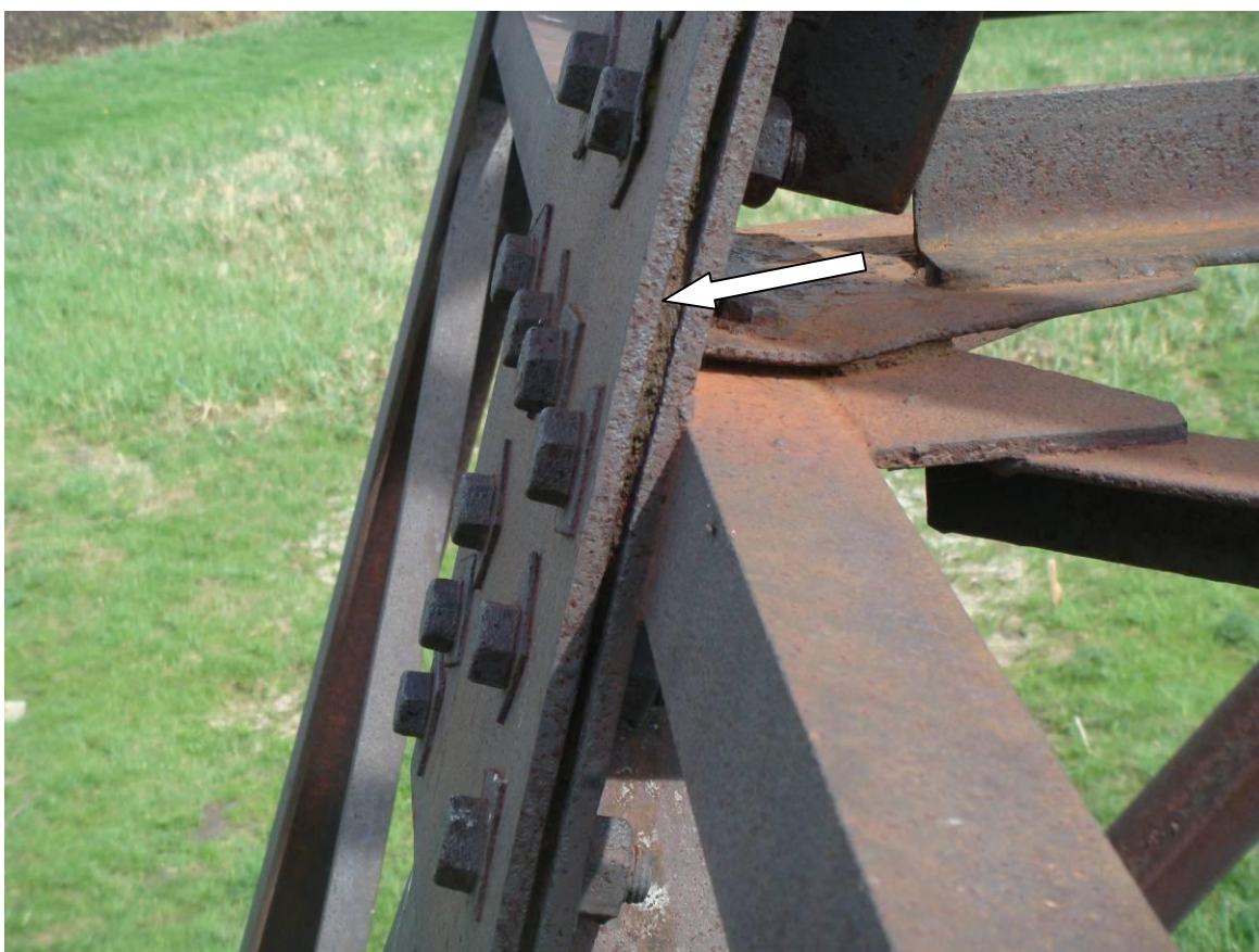
Рисунок Б.2.4 - Щелевая коррозия металла в соединительных фасонках опорных раскосов
