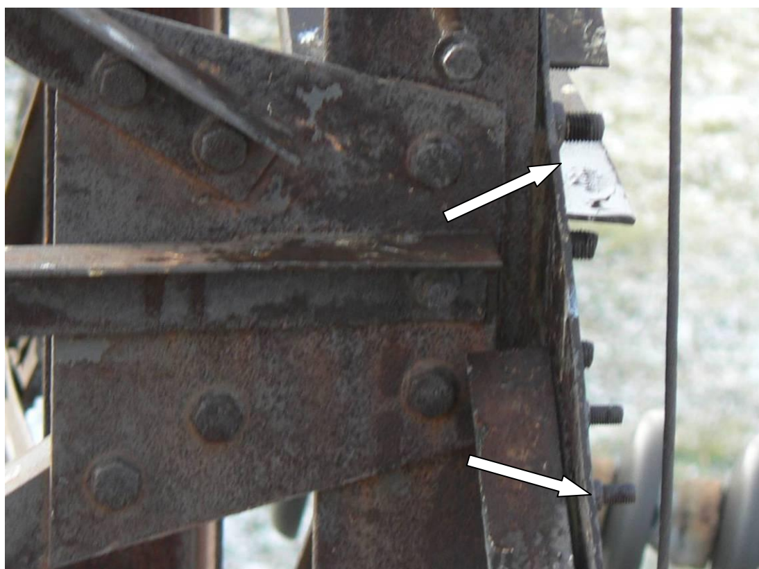
Рисунок Б.1.6 - Щелевая коррозия в фасонках стыковки траверс с деформацией элементов фасонки
