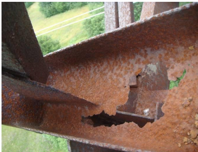
Рисунок Б.3.21 - Коррозия распорок и поясов тросостоек
