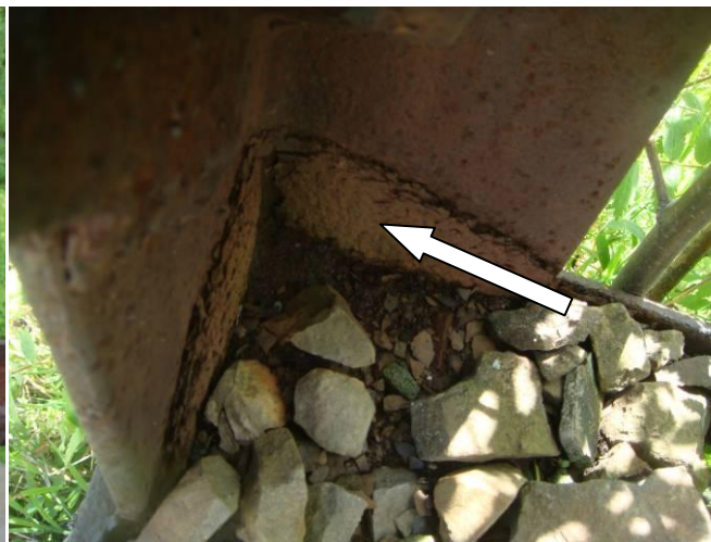
Рисунок Б.3.4 - Коррозия башмаков опор
