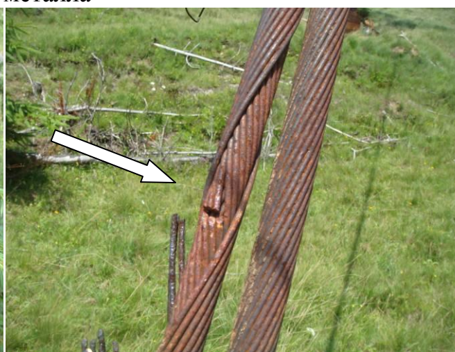
Рисунок Б.3.26 - В оп.343 в оттяжке перерезано 11 нитей
