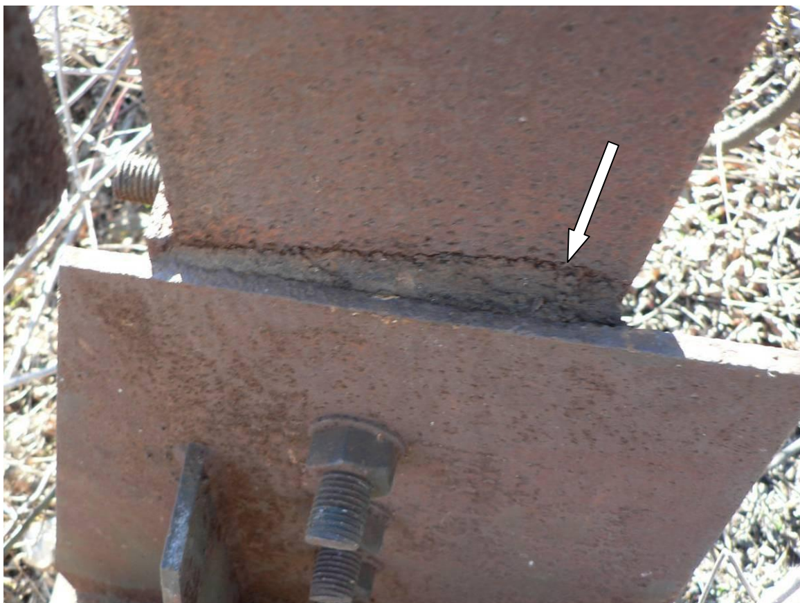
Рисунок Б.1.4 - Щелевая коррозия в фасонках башмаков
