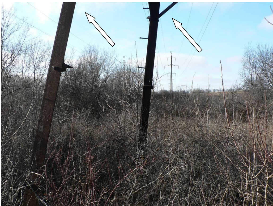
Рисунок Б.1.2 - Отсутствие опорных раскосов
