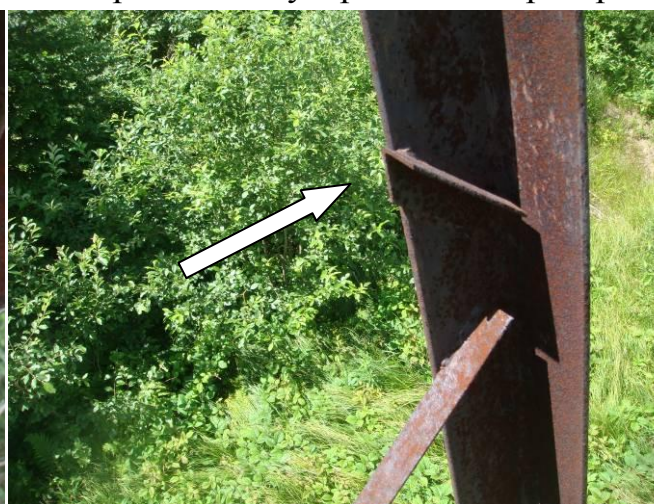
Рисунок Б.3.12 - Отсутствуют стержни опоры
