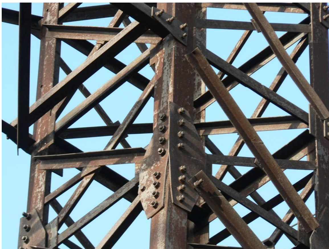
Рисунок Б.1.10 - Разрушение лакокрасочного покрытия
