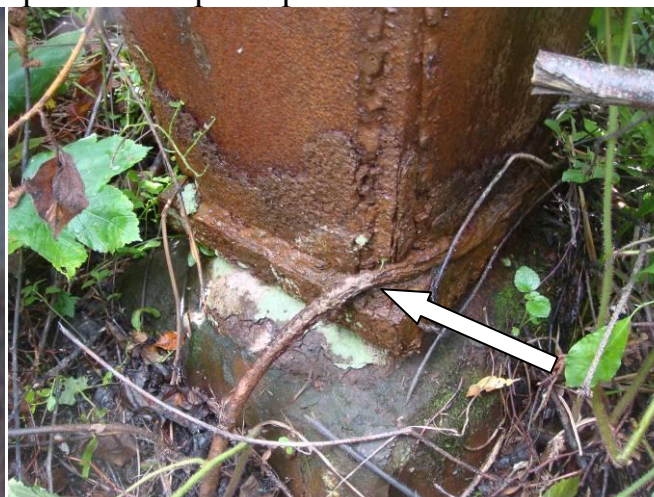
Рисунок Б.3.8 - Коррозионное повреждение заземления
