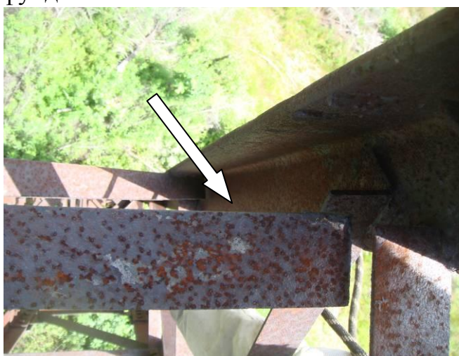
Рисунок Б.3.31 - Трещины в сварных швах
