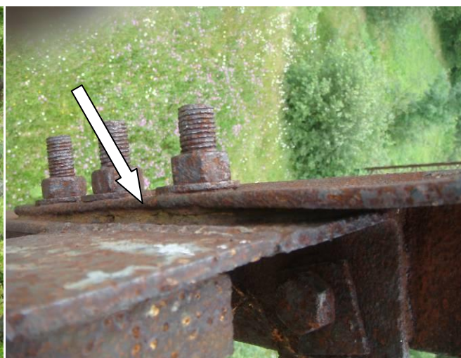
Рисунок Б.3.16 - Щелевая коррозия стыков поясов стоек
