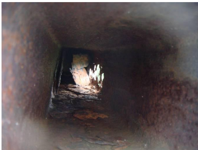
Рисунок Б.3.7 - Коррозия консолей крепления грозотроса
