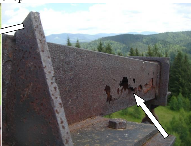
Рисунок Б.3.6 - Коррозия консолей крепления грозотроса
