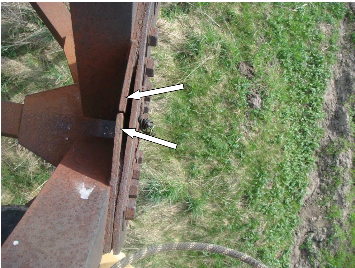
Рисунок Б.2.16 - Деформация фасонки
