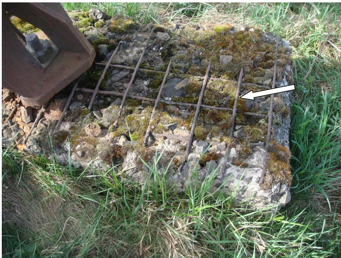
Рисунок Б.2.1 - Разрушение защитного слоя бетона фундаментов
