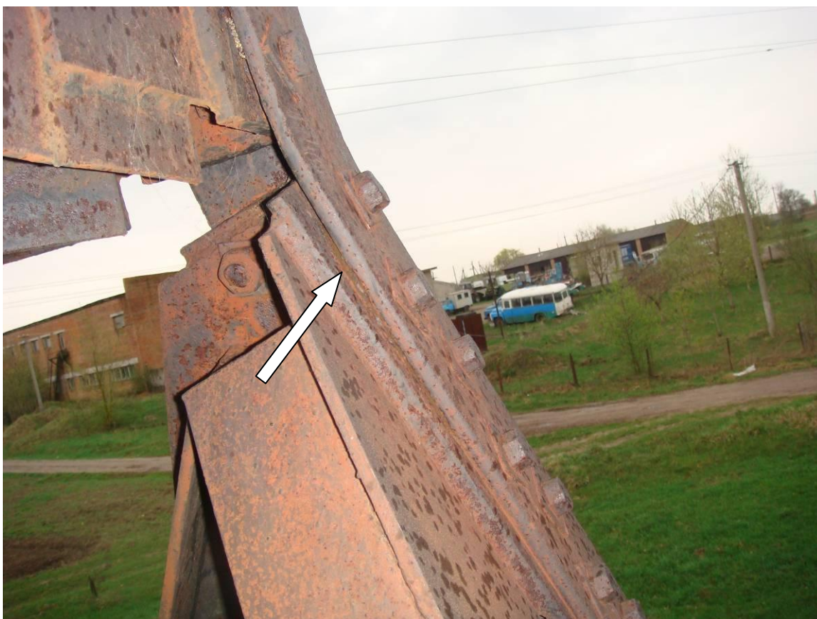
Рисунок Б.2.5 - Щелевая коррозия металла в стыках секций ствола опоры
