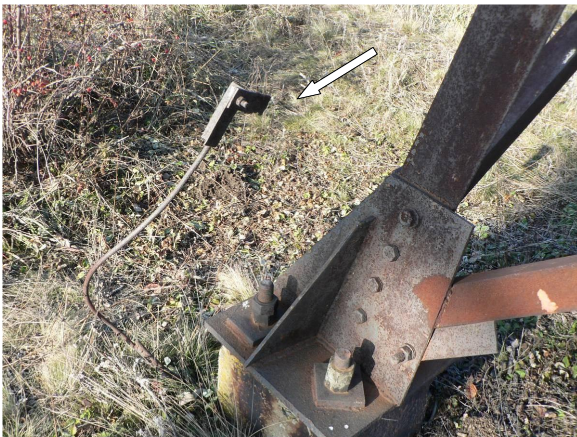
Рисунок Б.1.11 - Повреждение заземления опор
