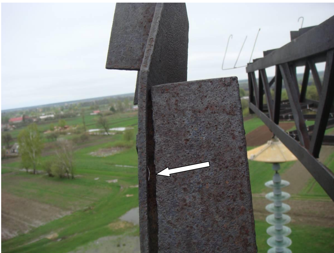
Рисунок Б.2.7 - Щелевая коррозия металла в фасонках крепления тросостоек
