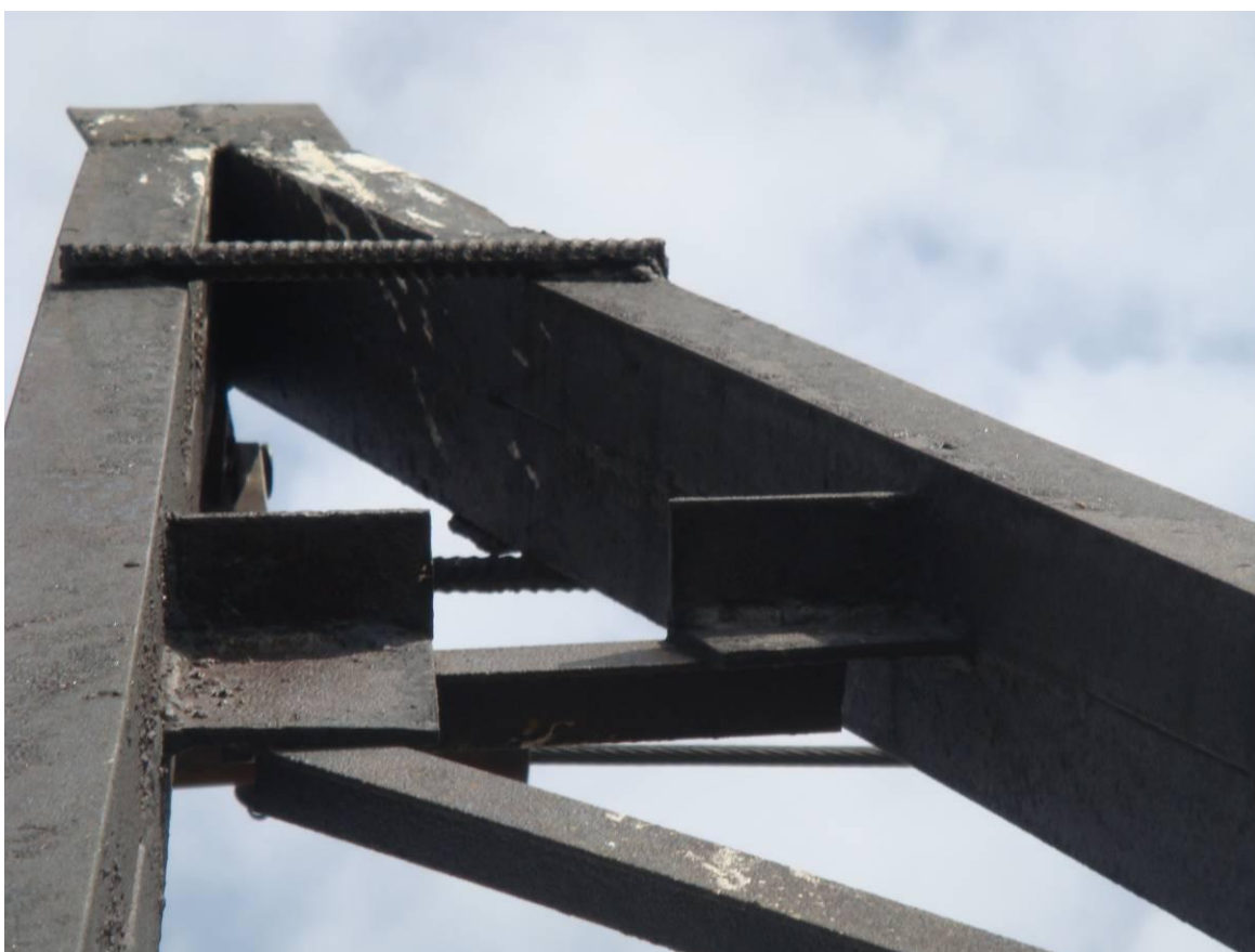
Рисунок Б.2.11 - Разрушение защитного лакокрасочного покрытия
