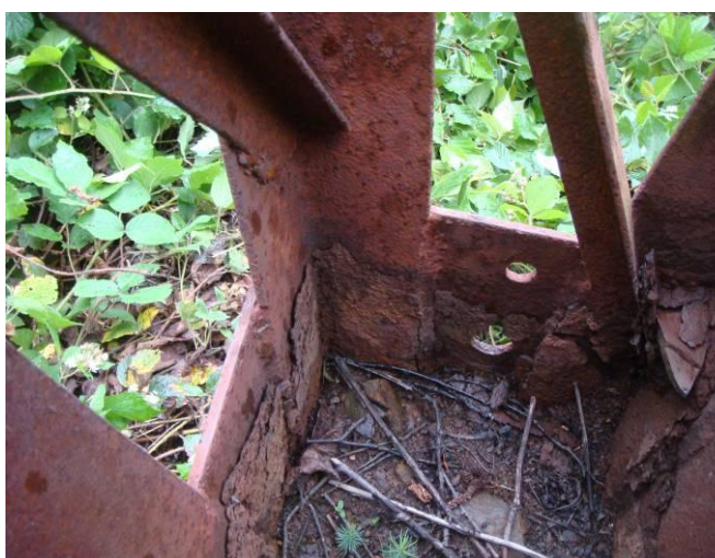
Рисунок Б.3.19 - Коррозия башмаков опор
