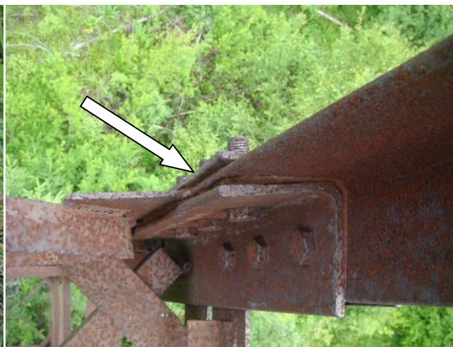
Рисунок Б.3.2 - Щелевая коррозия металла в стыках поясов стоек
