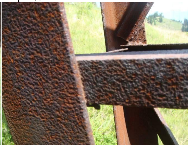
Рисунок Б.3.24 - Общая поверхностная коррозия и раковины на поверхности металла
