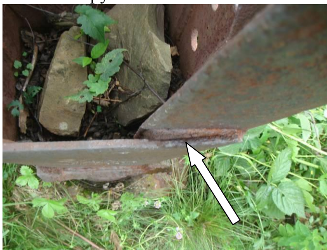
Рисунок Б.3.17 - Щелевая коррозия в месте примыкания пояса к фасонке башмака
