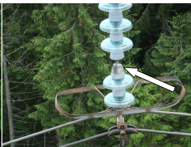
Рисунок Б.3.14 - Повреждение изолятора
