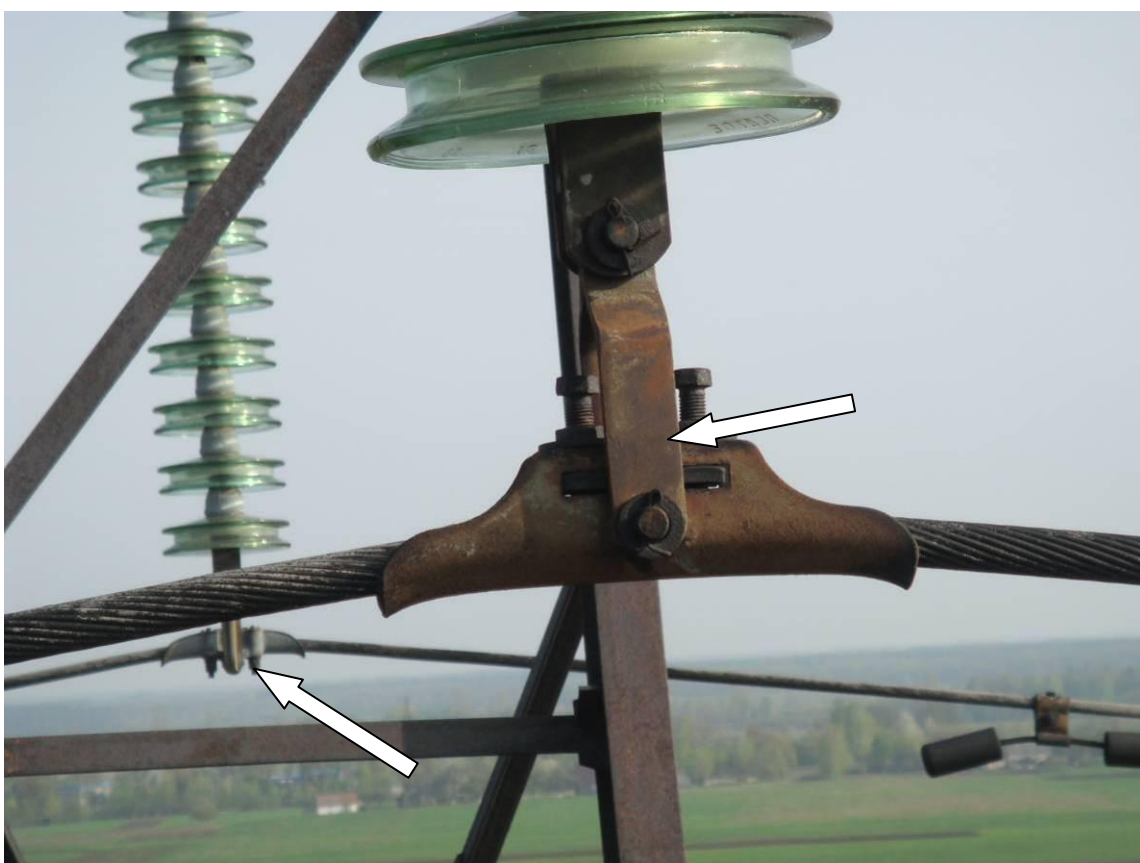
Рисунок Б.2.17 - Разрушение цинкового покрытия линейной арматуры
