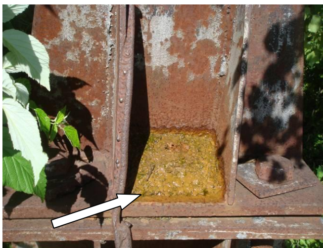
Рисунок Б.3.33 - В башмаках и подставках под них отсутствуют дренажные отверстия
