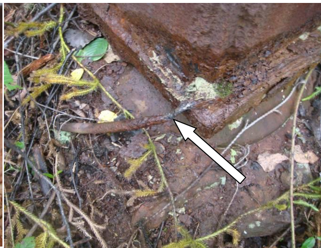
Рисунок Б.3.22 - Коррозионное повреждение заземления
