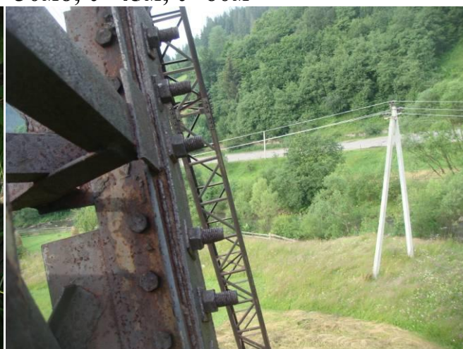
Рисунок Б.3.30 - Щелевая коррозия металла в соединениях
