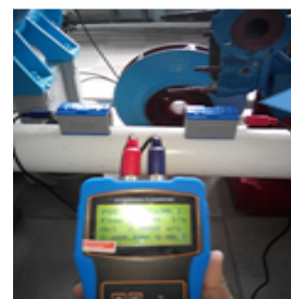
Поиск неучтенных расходов в водопроводной сети (утечи, несанкционированные подключения)
