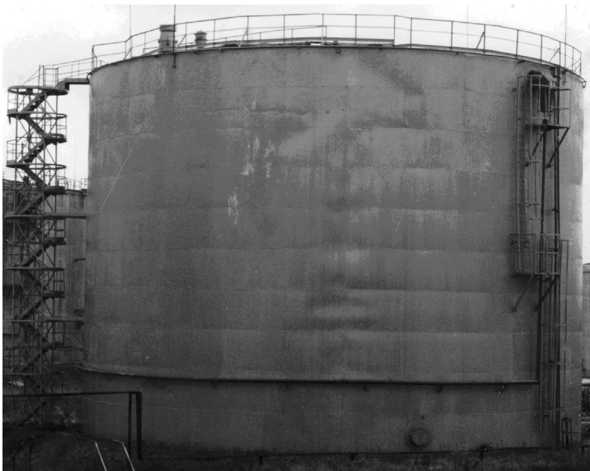
Рис. 4. Дефекты в зоне монтажного стыка.
