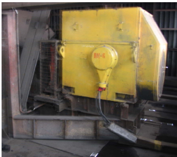
Рис. 3. Электродвигатель приводной станции ленточного конвейера.
