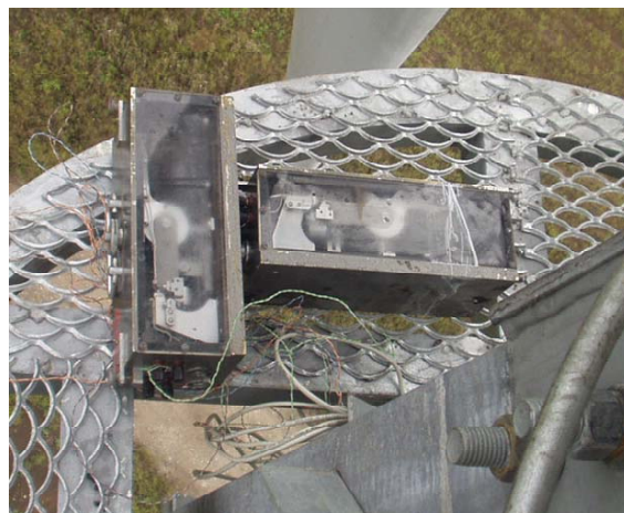
Рис. 4. Расположение ВЭГИКов на технологической площадке башни ВЭУ.
