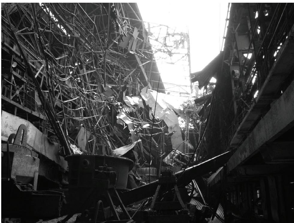
Рис. 3. Разрушение разливочного пролета (вид вдоль пролета).
