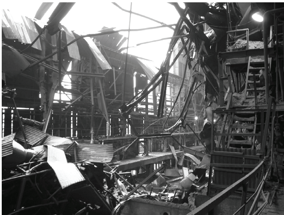
Рис. 1. Разрушение разливочного пролета (вид изнутри).
