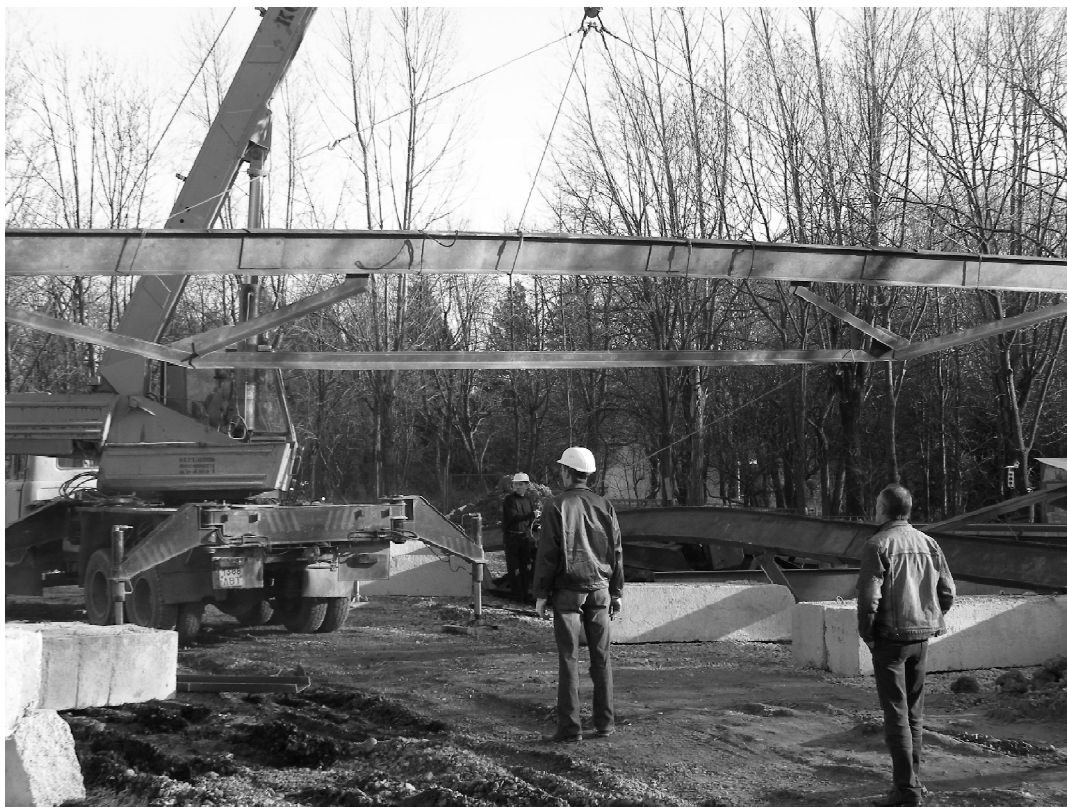
Рис. 2. Монтаж малоелементної шпренгельної ферми прольотом L=12 м. Санаторій «Женева», м. Трускавець, 2004 р.
