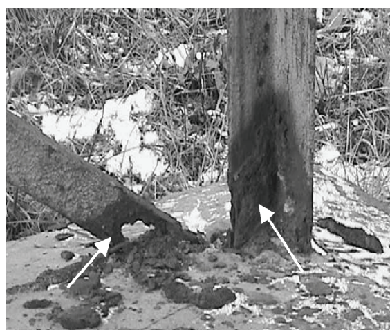
Рис. 4. Сквозное коррозионное поражение элементов стойки в уровне оголовка фундамента.
