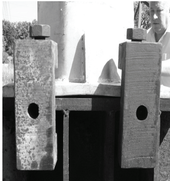
Рис. 3. Деформация базы опоры.
