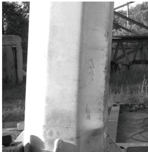
Рис. 5. Потеря устойчивости стенки опоры.
