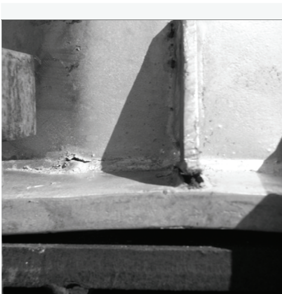
Рис. 4. Отрыв опорного ребра, трещина шва крепления стенки к базе опоры.
