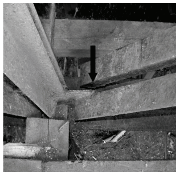
Рисунок 4. Разрушение сварных соединений в узлах крепления раскосов к нижнему поясу фермы пролётного строения конвейерной галереи.
