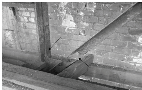
Рисунок 5. Местное коррозионное разрушение раскоса и стойки фермы пролётного строения конвейерной галереи.
