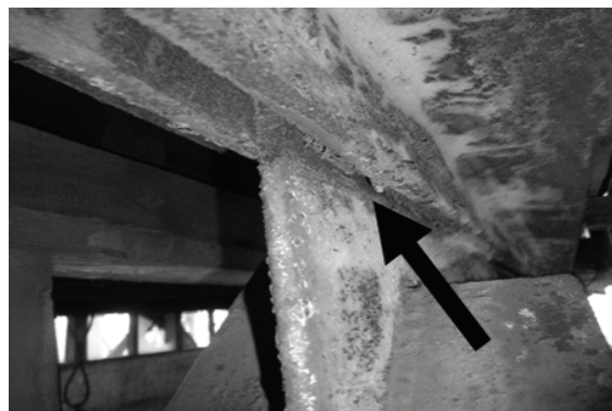
Рисунок 6. Разрушение сварного шва и остаточные деформации элементов узла вследствие распирающего действия коррозии в конструктивных зазорах.
