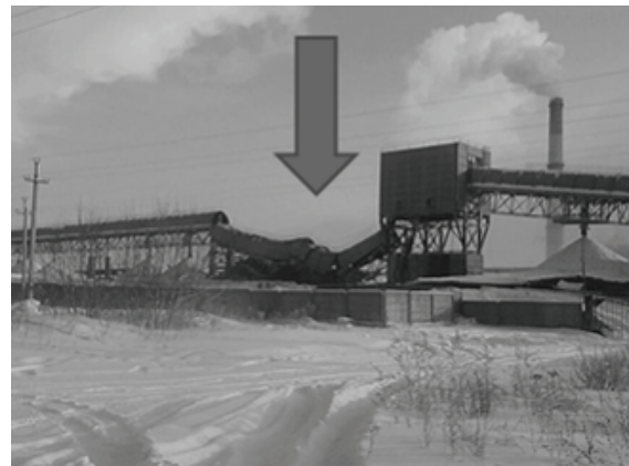
Рисунок 3. Разрушение пролётного строения конвейерной галереи.
