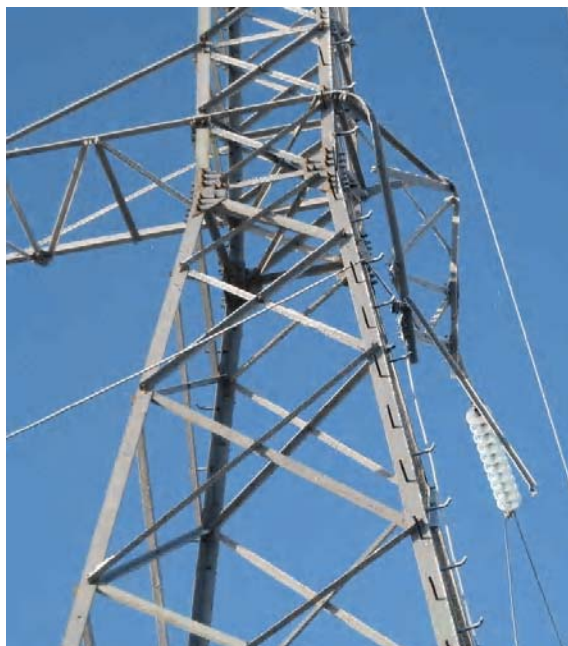
Рисунок 1. Разрушение траверсы опоры У100-4+5.
