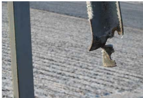
Рисунок 2. Разрушение тяги в узле крепления.
