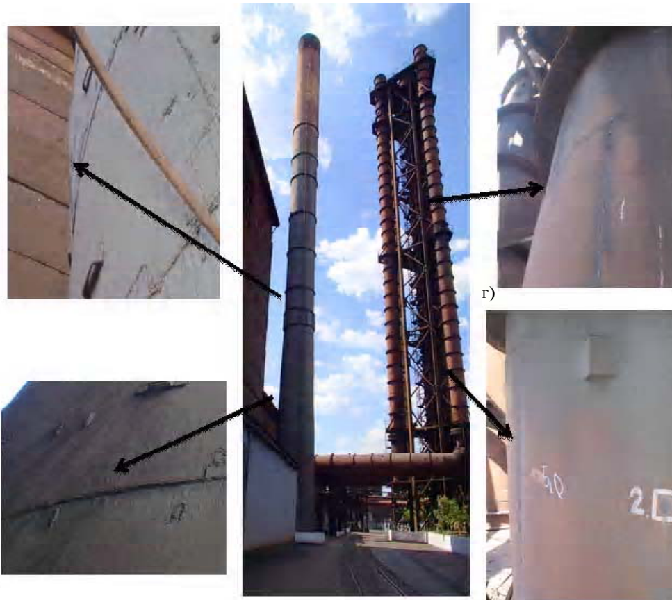
Рисунок 2. Геометрические отклонения: металлических дымовых труб: а) выпуклость/вогнутость оболочки; б) эксцентриситет стыковки цагр; газоотводящих стволов: в) вогнутость оболочки; г) увод кромок.
