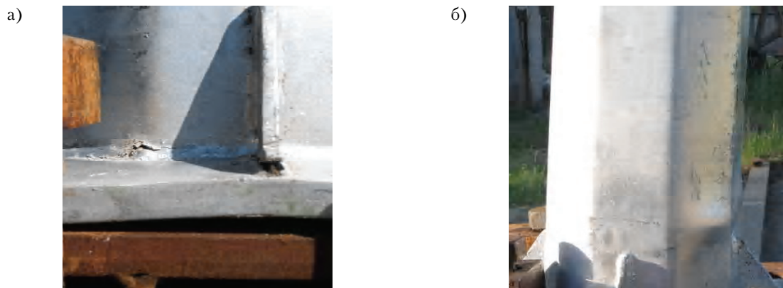
Рисунок 4. Разрушение металлических восьмигранных стоек: а) отрыв опорного ребра, деформация опорной плиты, трещина шва крепления стенки к базе опоры; б) потеря местной устойчивости стенки.
