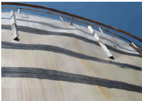
Рисунок 1. Потеря устойчивости верхних поясов стенки резервуара.
