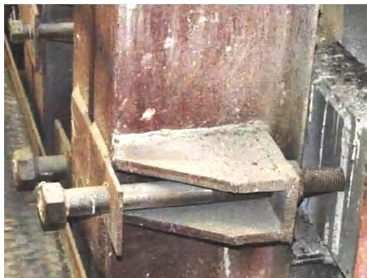
Рисунок 5. Тяж в реальной конструкции печи.
