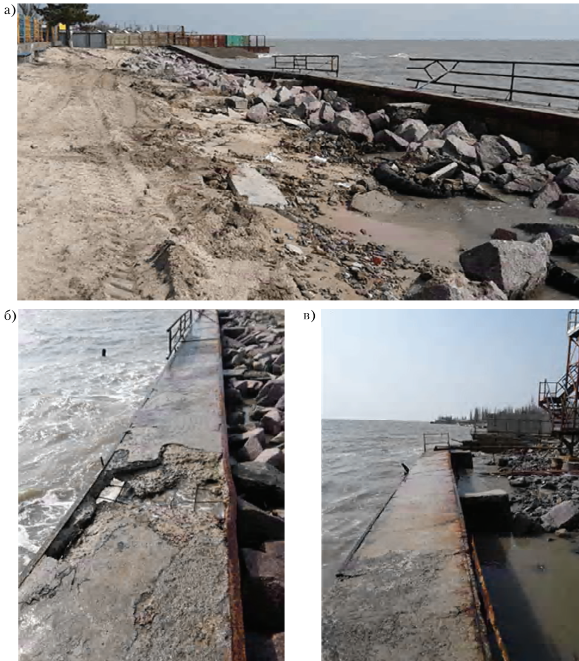
Рисунок 2. Сохранившийся участок подпорной стены: а – прогиб; б – раздробление бетона сжатой зоны в месте прогиба; в – крен в сторону моря.
