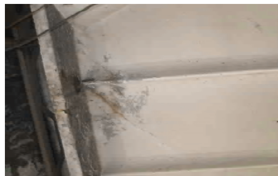
Рисунок 5. Отдельные железобетонные плиты покрытия, имеющие трещины вдоль и в поперечном направлении продольных ребер.
