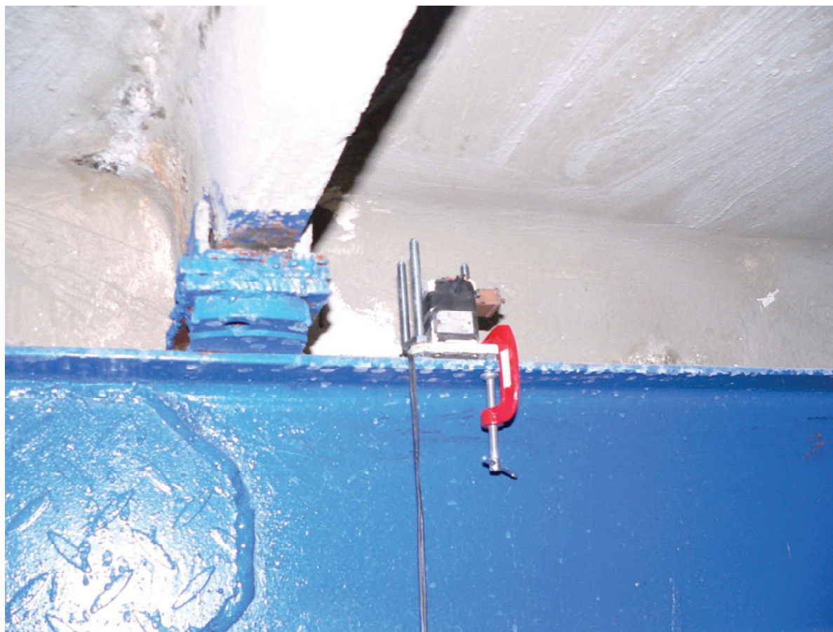
Рисунок 2. Крепление вибродатчика индуктивного типа на верхней полке стальной балки усиления плиты перекрытия.
