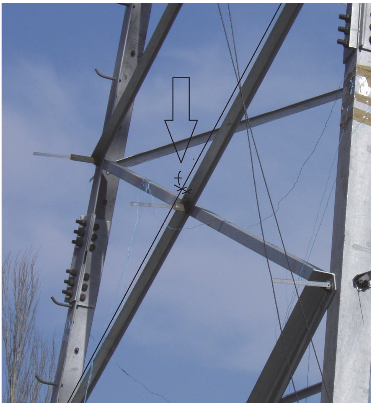
Рисунок 2. Фиксирование выгиба решетки нижней части опоры.
