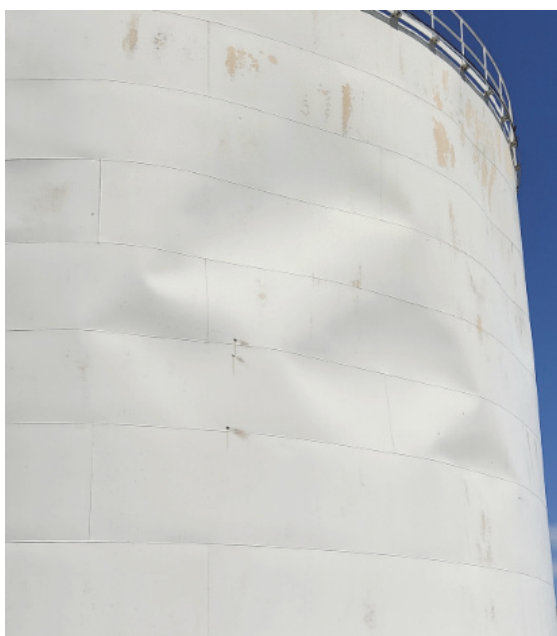
Рисунок 3. Местная потеря устойчивости стенки резервуара.
