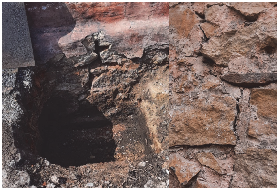
Рисунок 3. Конструкция фундамента изнутри и снаружи здания. Вертикальные трещины раскрытием до 20 мм.
