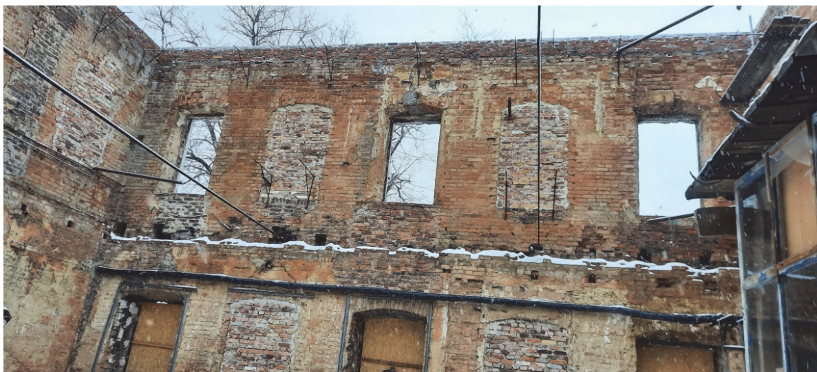
Рисунок 5. Закладка оконных проемов оси «А» без перевязки швов в кирпичной кладке. Трещины над заложенными оконными проемами, высолы на поверхности стен. Разрушения кирпичной кладки над оконными проемами. Выпадение отдельных кирпичей в месте изменения толщины стены на отм. +4.270.
