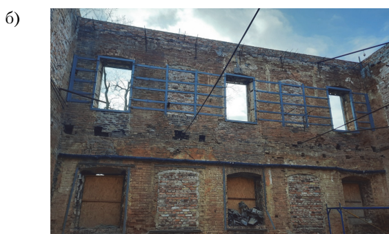
Рисунок 8. Этапы выполнения металлических обоем в стенах здания в осях «А»–«Б» и «2»–«3»: а) начало работ – усиление оконного проема двухсторонними металлическими обоями; б) окончание установки металлических двухсторонних обоем усиления оконных проемов по оси «А» в осях «2»–«3».
