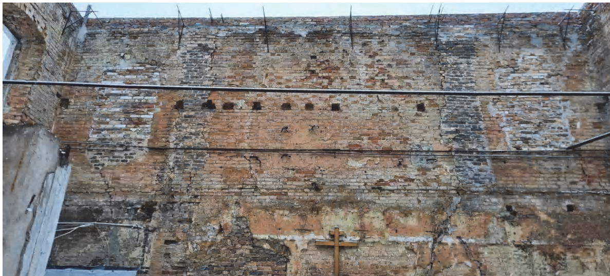
Рисунок 4. Вертикальные трещины раскрытием 20 мм и более, разрушение кладочного раствора и кирпича на глубину до 120 мм, высолы на поверхности поперечной стены по оси «3».
