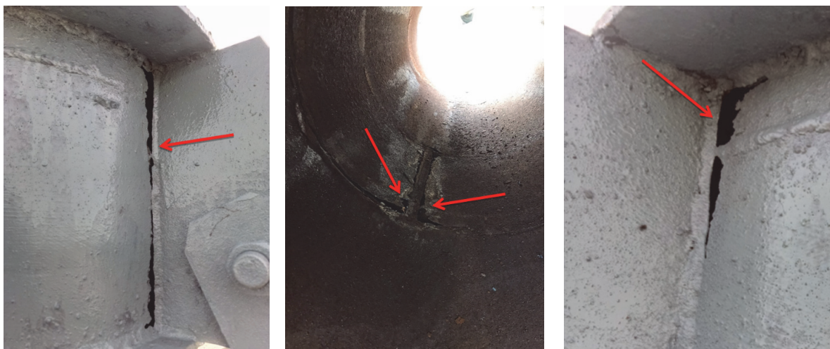
Рисунок 3. Сквозные коррозионные повреждения в лацменном узле 2-го уровня оттяжек.
