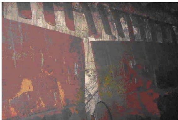
Рис. 11. Разрушение воронки в месте обрыва «языков».
