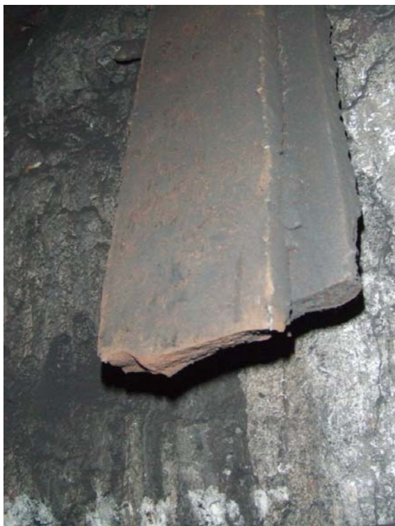
Рис. 4. Хрупкое разрушение «языка».
