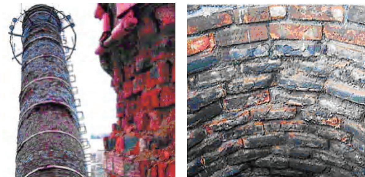
Рис. 1. Повреждения внутренней части футеровки дымовой трубы по причине атмосферной и химической коррозии.
