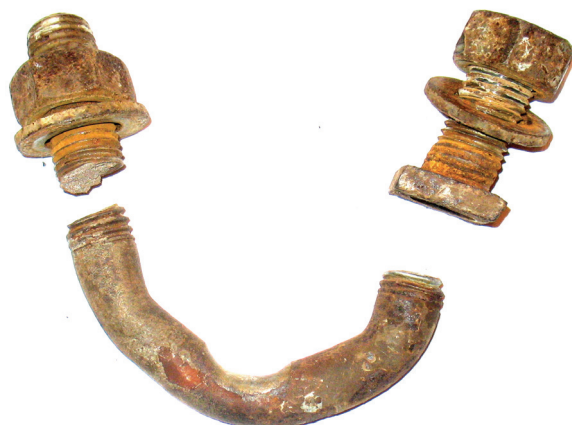
Рис. 5. Разрыв U-образного болта. Опора № 196 ВЛ 330 кВ «Каховская – Островская».
