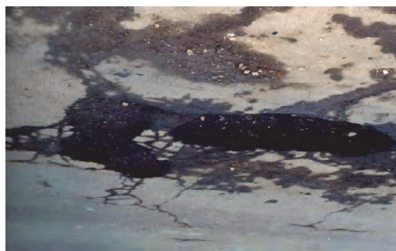
Рисунок 4. Выбоины на асфальтобетонном покрытии.
