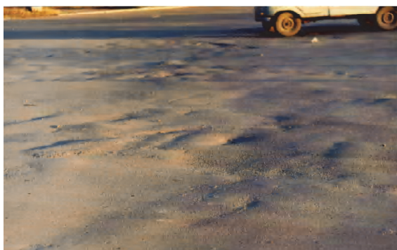
Рисунок 1. Сдвиг покрытия из мелкозернистого асфальтобетона с образованием волн.
