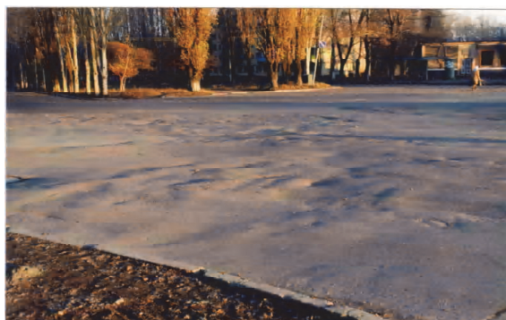
Рисунок 3. Сдвиг покрытия из мелкозернистого асфальтобетона с образованием волн.
