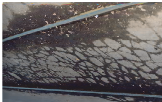
Рисунок 2. Хрупкий разрыв асфальтобетонного покрытия.
