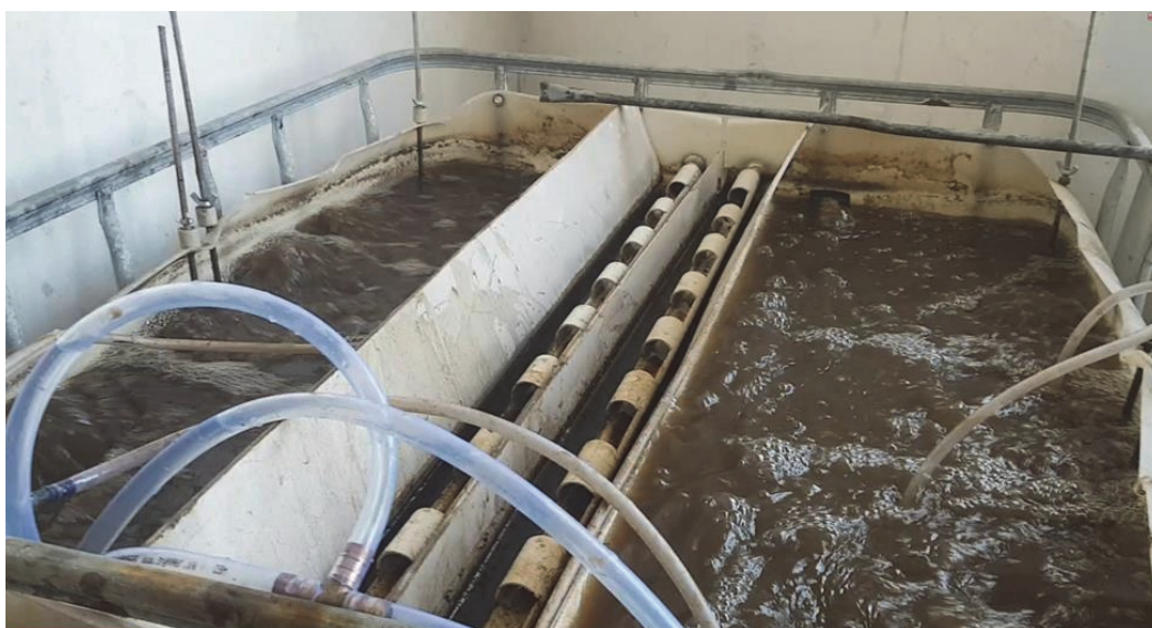
Рисунок 3. Общий вид аэротенка-осветлителя с затопленной эрлифтной системой аэрации.
