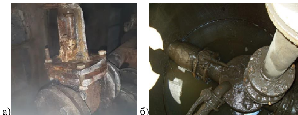
Рисунок 2 – Неисправное оборудование на сети: а) задвижка; б) пожарный гидрант
