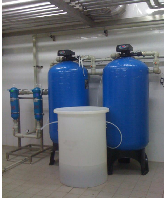
Рисунок 8 - Станция водоподготовки для котельной
