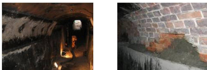
Рисунок 1— Характерные повреждения подземных сооружений
