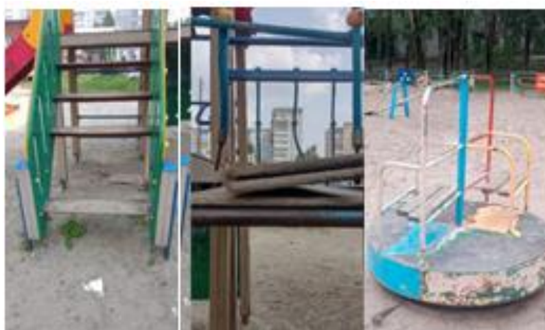
Рисунок 2 — Ветхое состояние оборудования детской площадки в г. Томске, ул. Мюнниха, 22 (фото «РЕГИОН-70»)
