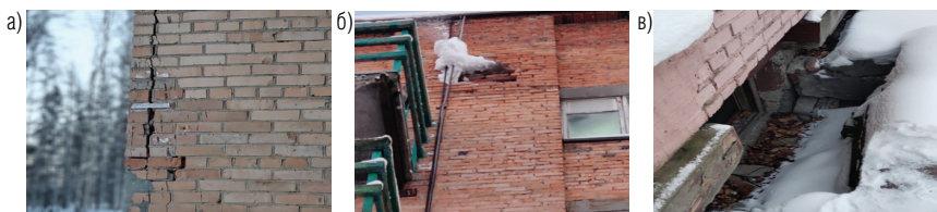
Рисунок. а) отслаивания каменной кладки стены; б) образование куржака с последующим разрушением кирпичной кладки стены; в) приямок здания.
