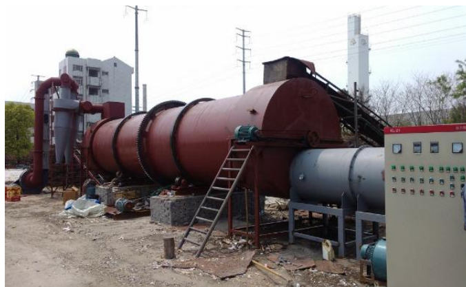
Рисунок 1 — Пиролизная установка по переработке ТКО
