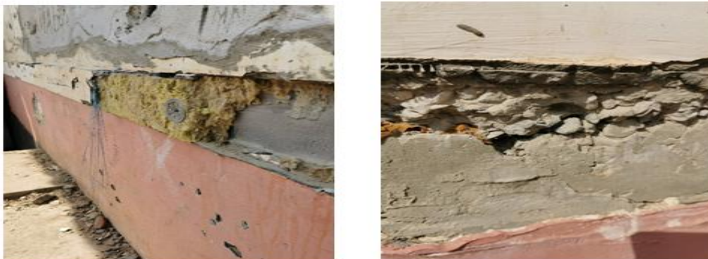
Рисунок 4 — Разрушение утеплителя межэтажных швов
