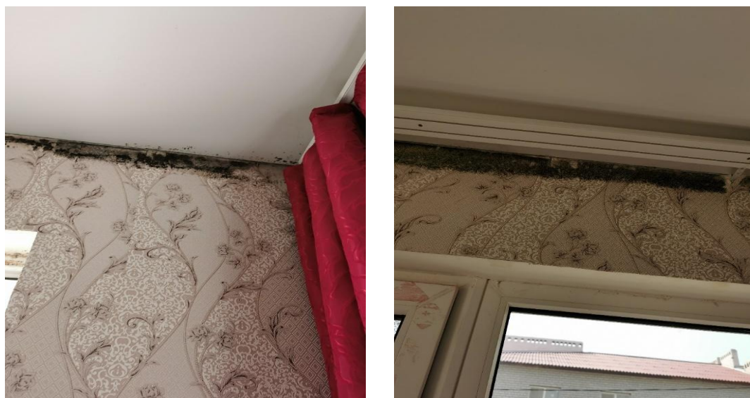
Рисунок 5 — Наличие плесени в квартирах со стороны поврежденных межэтажных швов.
