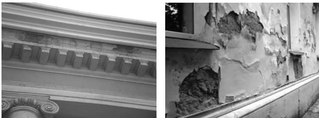
Рисунок 1 – Дефекты фасадов зданий.
