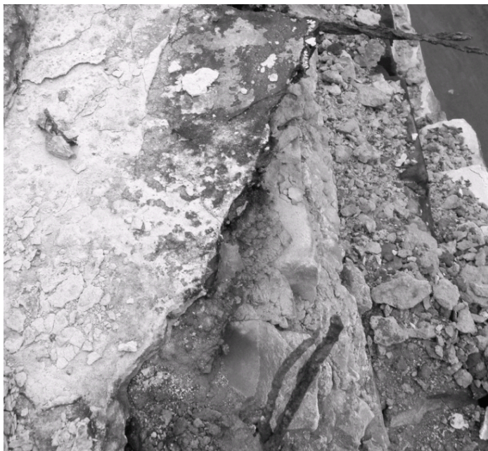
Фото 1 – Состояние (100 % коррозия) скруток, использованных для временного закрепления упавшей козырьковой плиты.
