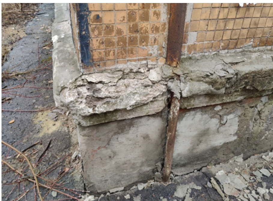
Рисунок 2 – Дефект фундамента на восточном фасаде.
