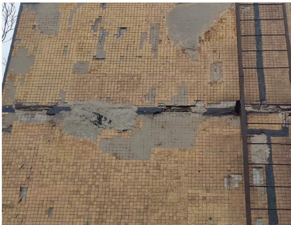
Рисунок 3 – Дефекты на восточном фасаде.
