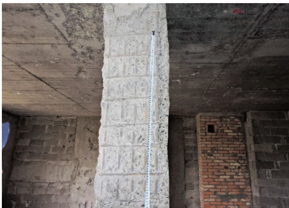
Рисунок 4 – Вид поврежденного ребра монолитного железобетонного пилона.
