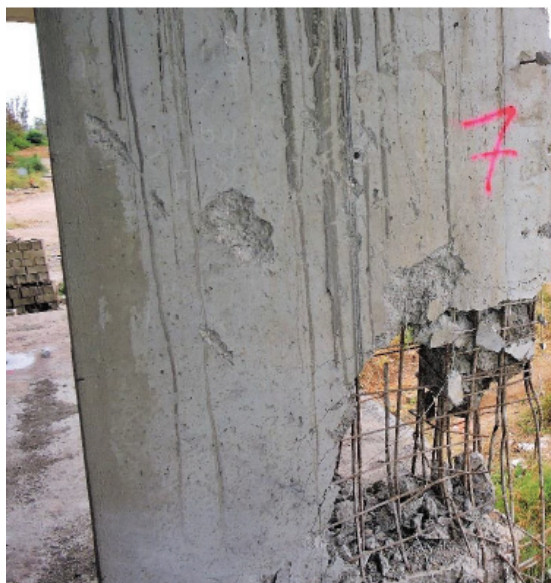
Рисунок 3 – Вид аварийного участка в опирании пилона.
