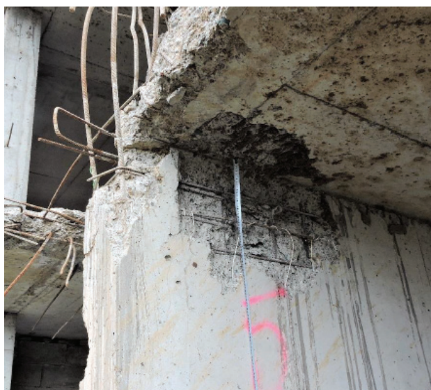
Рисунок 2 – Фрагмент монолитного железобетонного пилона с повреждением бетона и арматуры в узле опирания плиты перекрытия.
