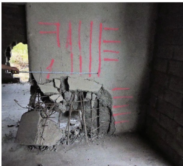
Рисунок 1 – Фрагмент аварийного монолитного железобетонного пилона.
