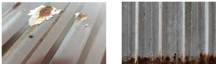
Рисунок 3 – Коррозионный износ стального профиля.
