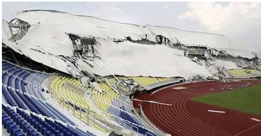
Рис. 1.9. Аварии покрытий над трибунами стадионов:
