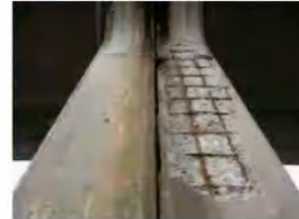
Отслоение защитного слоя бетона
