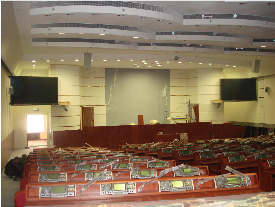
Зал заседаний Верховного совета ДНР. Потолки, перегородки и облицовки стен из материалов компании «Кнауф»
