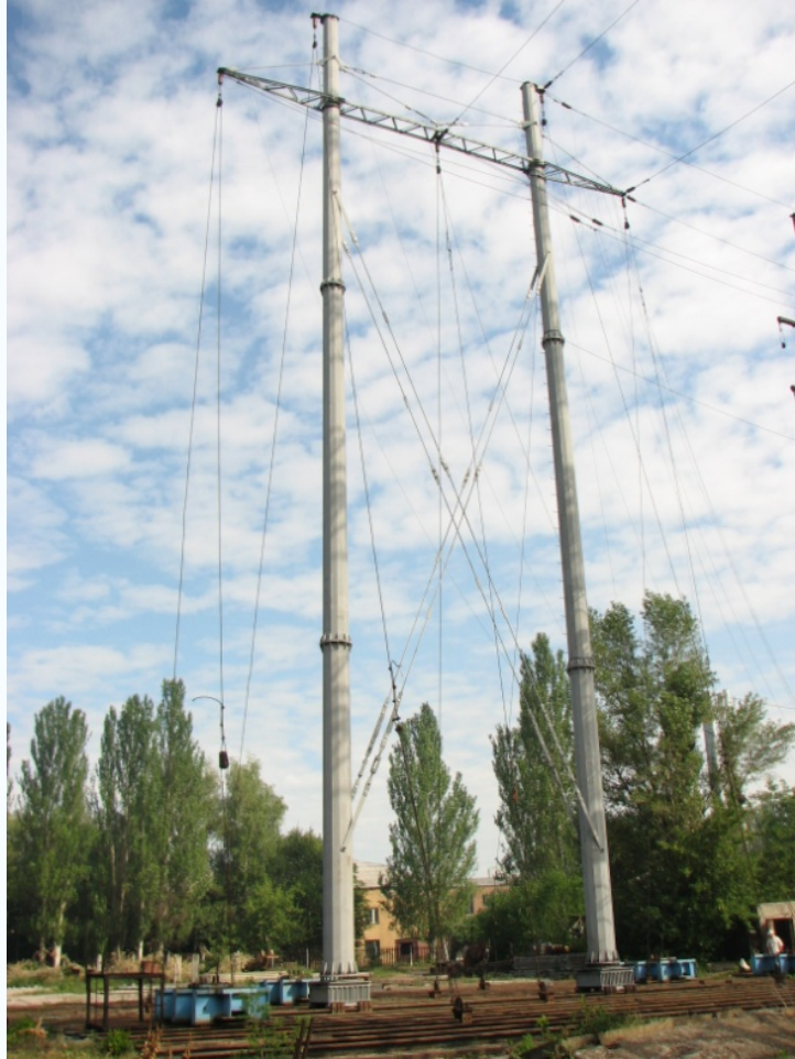
Общий вид опоры ПМГЗ30-28
