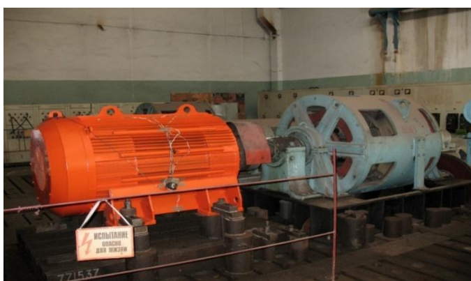
Рисунок 2.1 – Стенд для испытания электродвигателей до 1000 кВт
