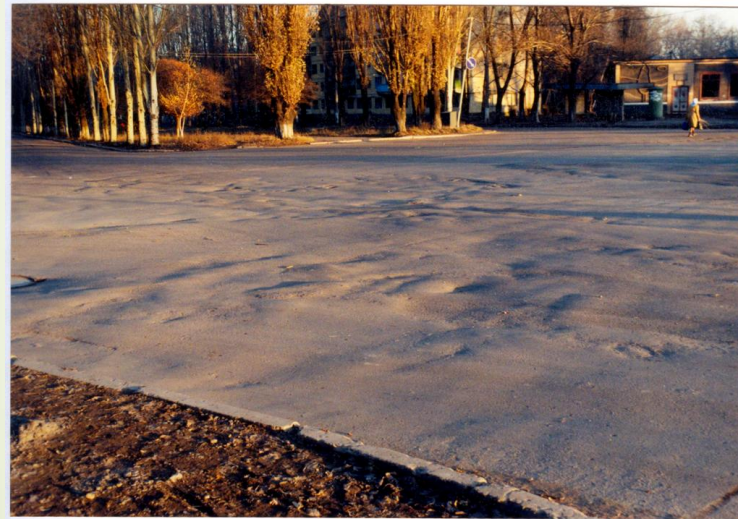
Сдвиг покрытия из мелкозернистого асфальтобетона с образованием волн
