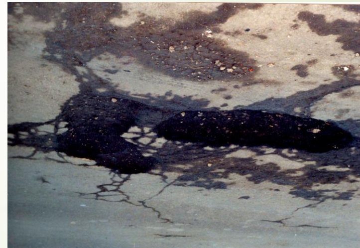
Выбоины на асфальтобетонном покрытии
