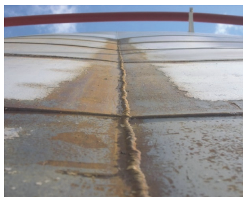
Рисунок 2. Вертикальный цилиндрический резервуар: а) численное моделирование потери устойчивости резервуара с двумя КЖ; б) дефект угловатости вертикального монтажного сварного шва.
