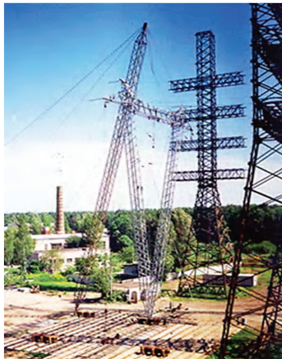
Рисунок 3. Общий вид промежуточной одноцепной опоры на оттяжках VS 32,2 400 кВ (Исландия) и страховочной мачты).
