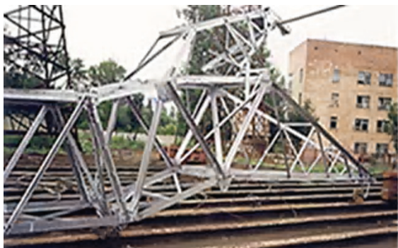
Рисунок 4. Демонтированная траверса опоры VS 32,2 400 кВ после разрушения.
