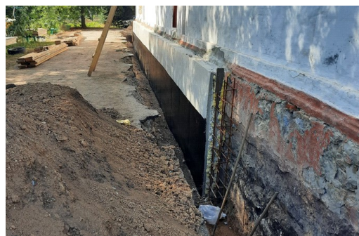
Рисунок 9. Устройство монолитного железобетонного пояса для стабилизации осадок здания, эксплуатируемого на просадочных грунтах.
