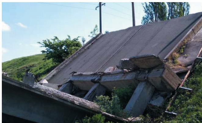
Рис. 2. Путепровод после повреждений: а – опора 3; б – опора 2
