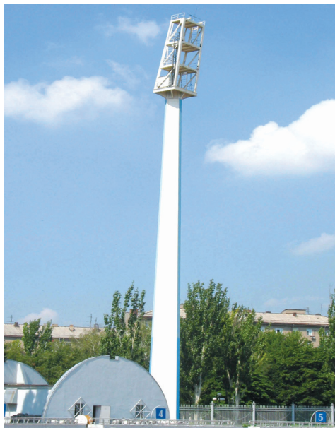
а) осветительная опора
