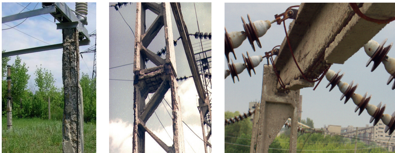
Рис. 2. Износ строительных конструкций открытых распределительных устройств подстанций
