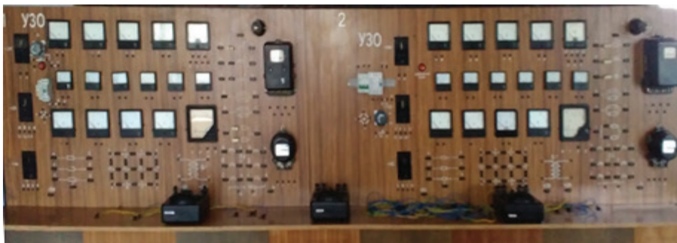
Рис. 2 Лаборатория электротехники и электроснабжения
