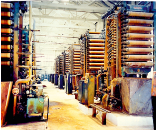
Рис. 3. Цех пресс-фильтров обезвоживания шламов нейтрализации Харцызского сталепроволочно-канатного завода
